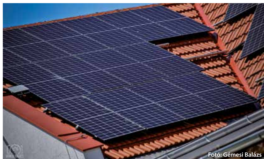
Öt önkormányzati intézményre kerültek napelemek, melyek az épületek üzemeltetési költségeit fogják csökkenteni
